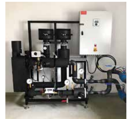
Im Keller der KundInnen: Wärmetauscher speist Fernwärme in die Heizung ein
